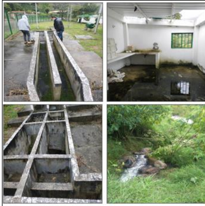
Figura 9. Evidencia Fotográfica visita PTAR TONA
