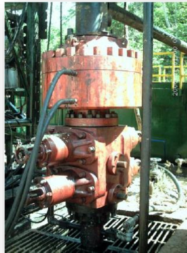
Figura 10. Conjunto de preventoras. Arriba preventora anular y abajo preventora de arietes
