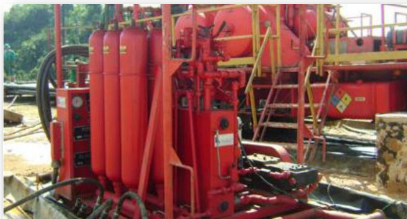
Figura 9. Acumulador de presión
