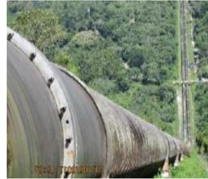
Figura 4. Tubería forzada central Paraíso.
