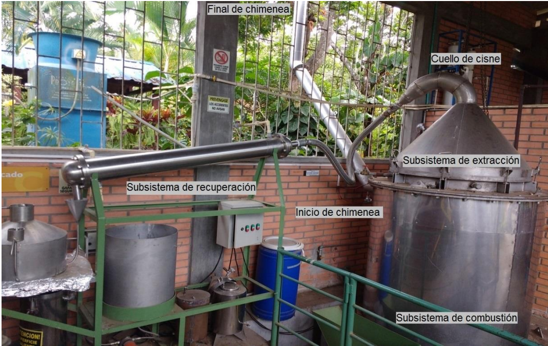
Figura 17. Planta de hidrodestilación en CENIVAM-UIS
