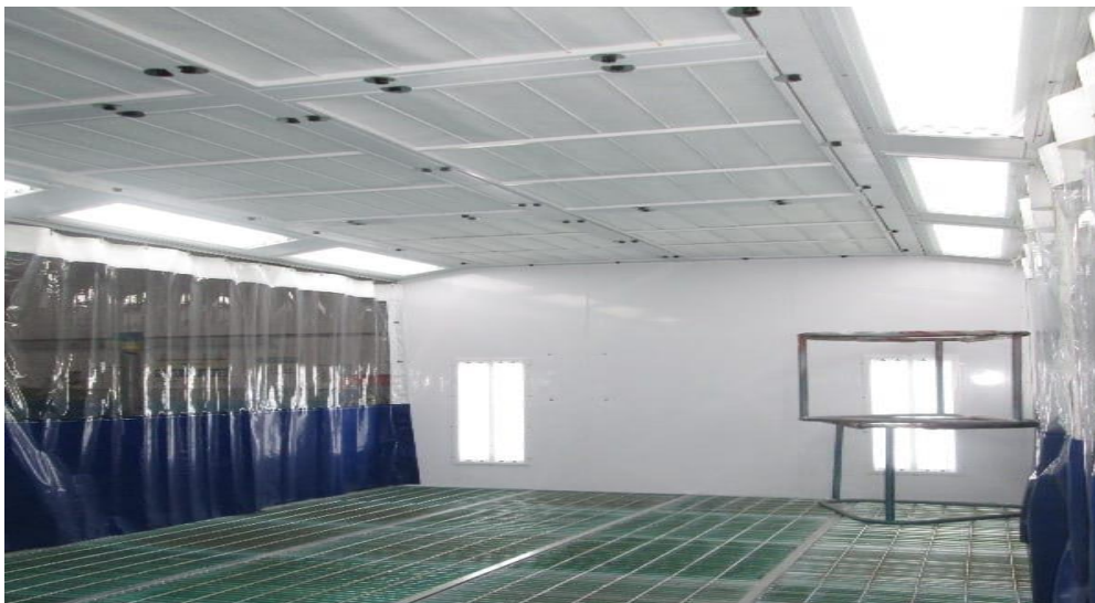
Figura 16. Cabina de pintura
