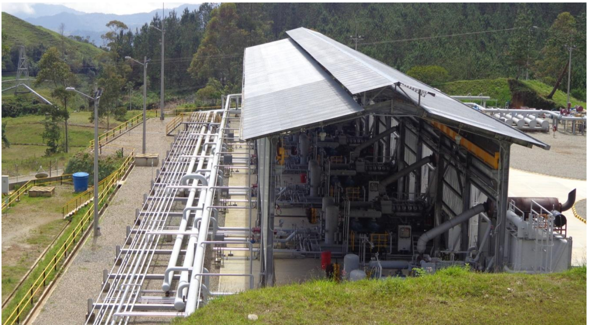
Figura 2. Shelter de compresores
