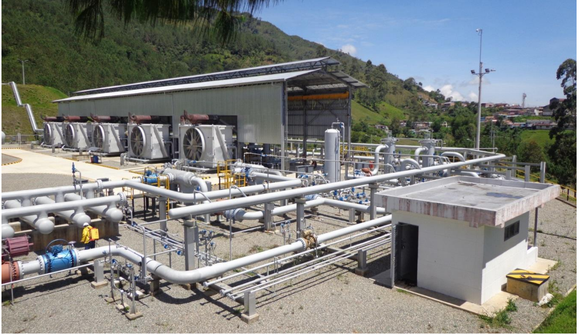
Figura 3. Tuberías de proceso
