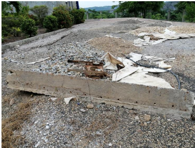
Figura 10. Sistema de filtración desmontado
