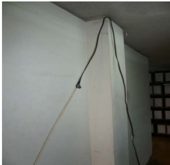
Imagen 9. Instalaciones eléctricas archivo central
