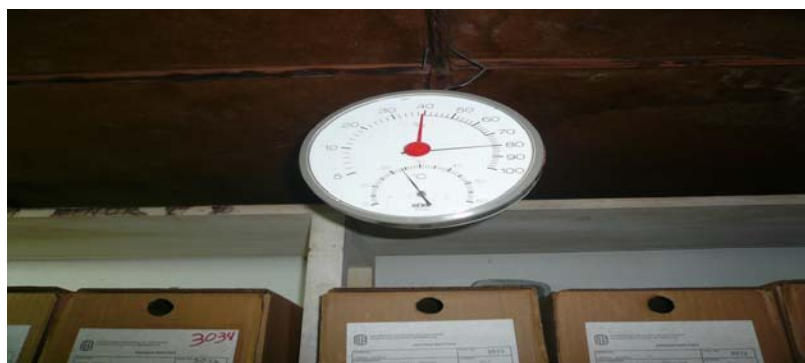
Imagen 8. Termohigrómetro instalado en el archivo central
