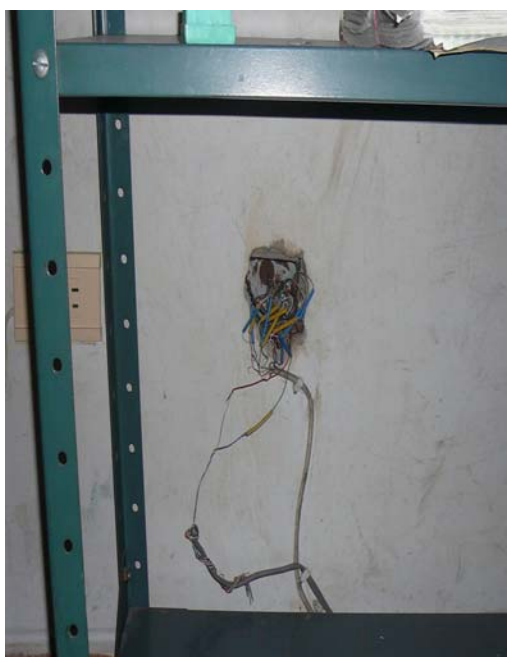
Figura 11. Instalaciones eléctricas archivo central
