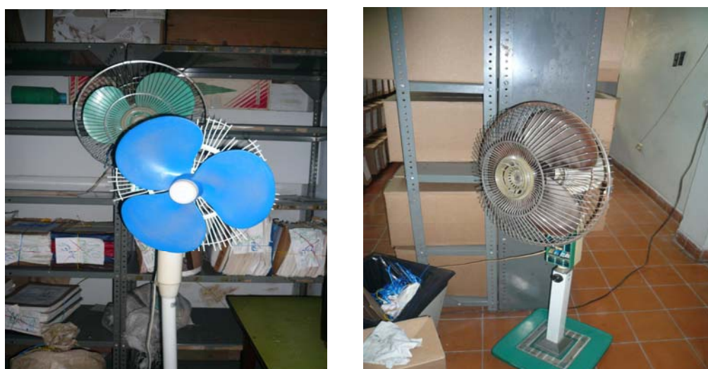
Imagen 4. Ventiladores archivo central
