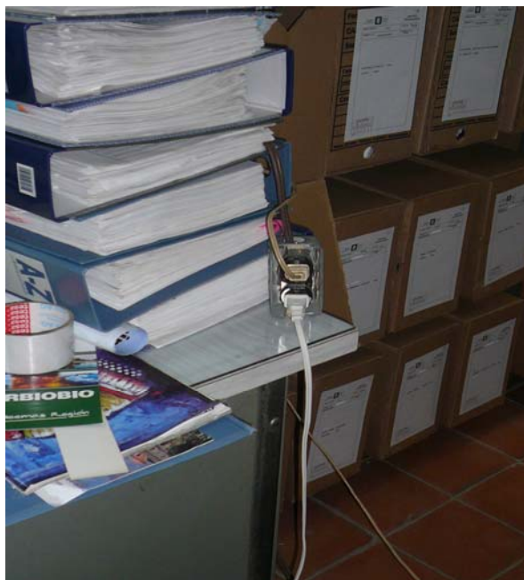
Figura 10. Instalaciones eléctricas archivo central
