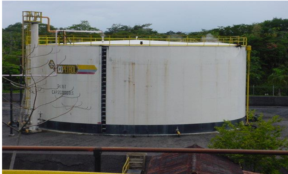
Figura 2. Tanque de almacenamiento de crudo.
