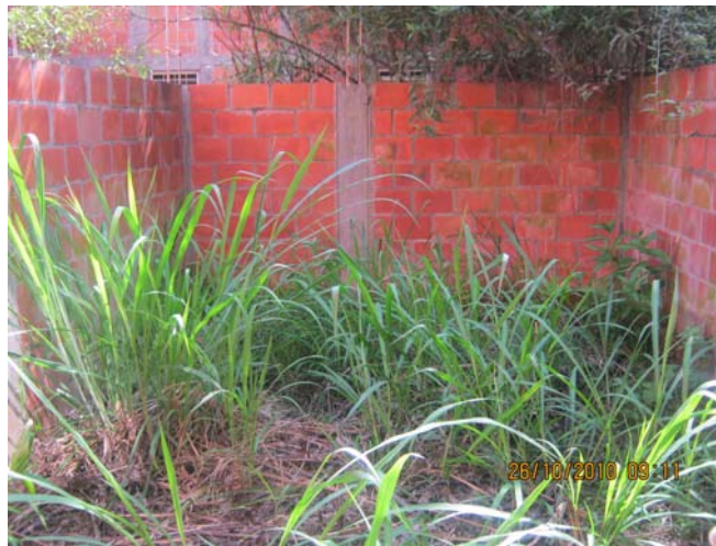
Foto 3. Estado del patio en Betania, Etapa 12, Manzana B, Casa 28
