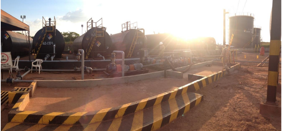
Figura 12. Sistema de almacenamiento de crudo y agua
