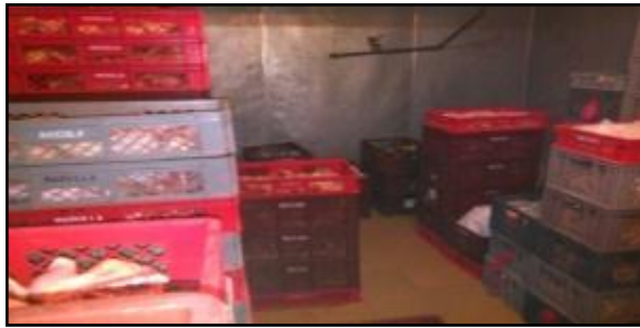
Figura 8. Cuarto frío del centro de producción
