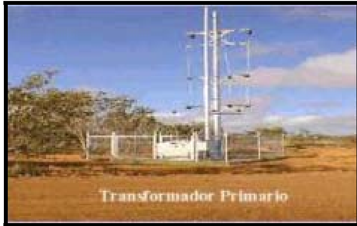
Figura 13. Transformador Primario para Calentamiento Resistivo.
