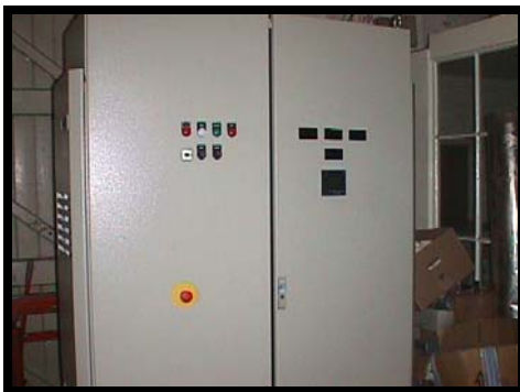
Figura 1a. Variador de frecuencias
