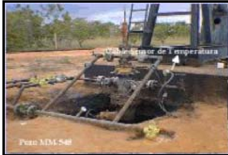
Figura 10. Cabezal de bombeo para calentamiento resistivo Campo Melones, Venezuela.
