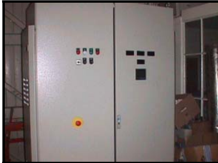
Figura 17. Variador de Frecuencia.
