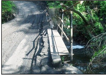
Figura 79. Detalle superficie de rodadura - baranda. Puente Guamacá.
