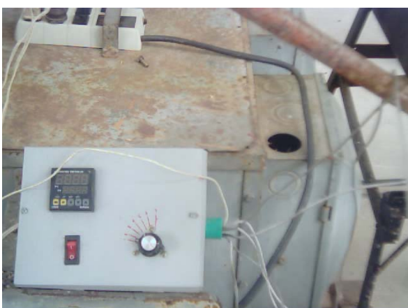
Imagen 7. Controlador de temperaturas
