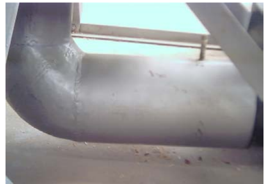
Imagen 15. Ducto de entrada del aire al sistema
