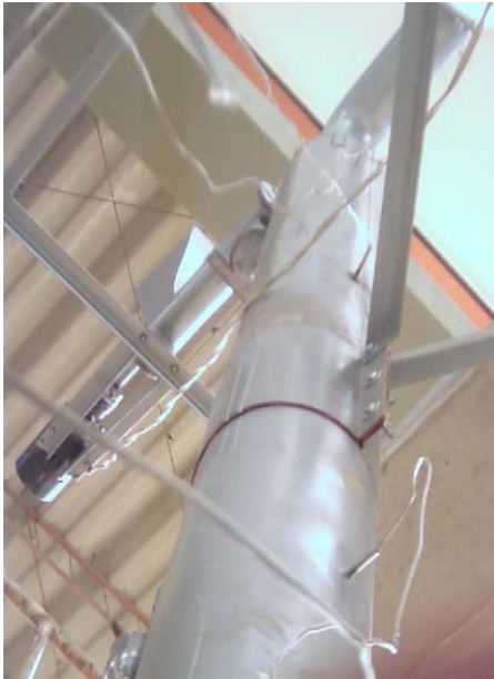
Imagen 17. Cuerpo del gasificador. Vista lateral
