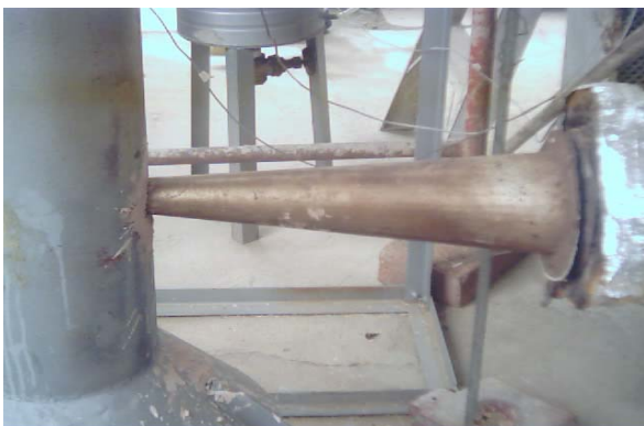
Imagen 6. Cono de entrada del gas caliente al sistema.
