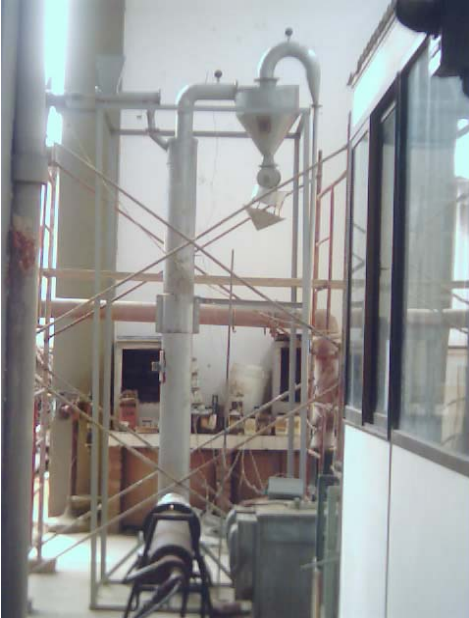
Imagen 1. Montaje completo del gasificador
