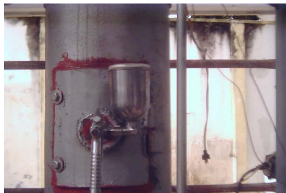
Imagen 9. Alimentación de agua Vista frontal
