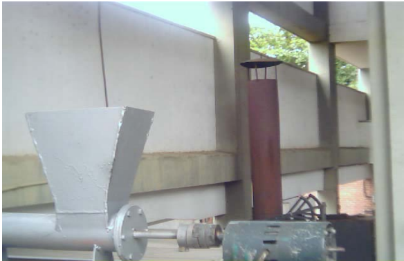
Imagen 11. Subsistema de alimentación de cascarilla. Tolva-tornillo-Motorreductor
