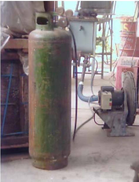
Imagen 2. Cilindro y soplador de aire de combustión de GLP
