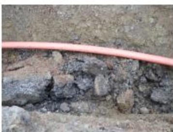
Imagen 12. Tendido de la tubería con presencia de jorobas
