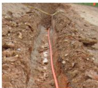
Imagen 15. zanja con presencia de fango o barro
