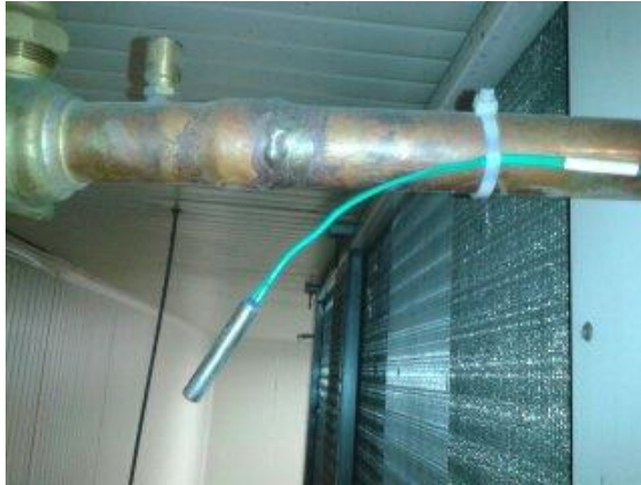
Figura 21. Sensor de Temperatura de Succión. Fuente: Autores del Proyecto.
