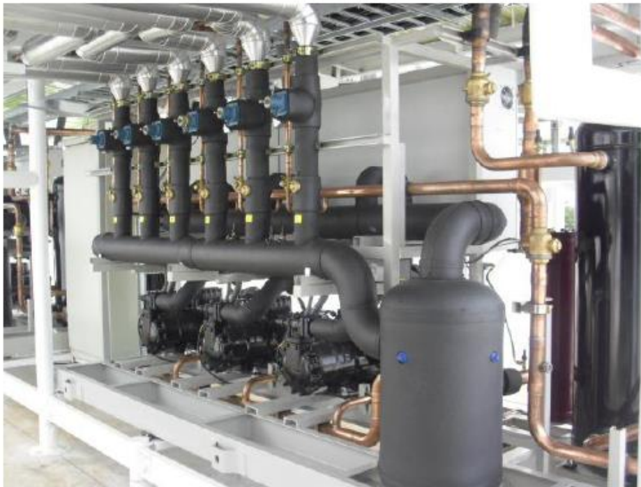
Imagen. 8. Rack de Refrigeración No 1 Bodega Lanco
