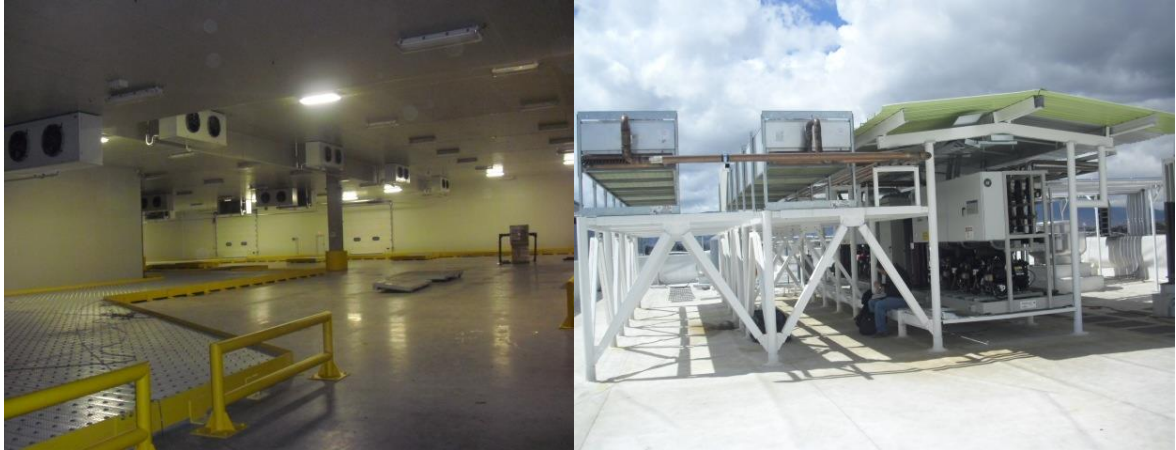
Imagen. 13. Rack de Refrigeración de la Bodega Lan Cargo.
