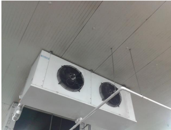
Imagen. 16. Evaporador ubicado al interior del cuarto Frío
