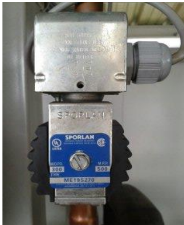
Imagen. 25. Válvula solenoide tubería de líquido
