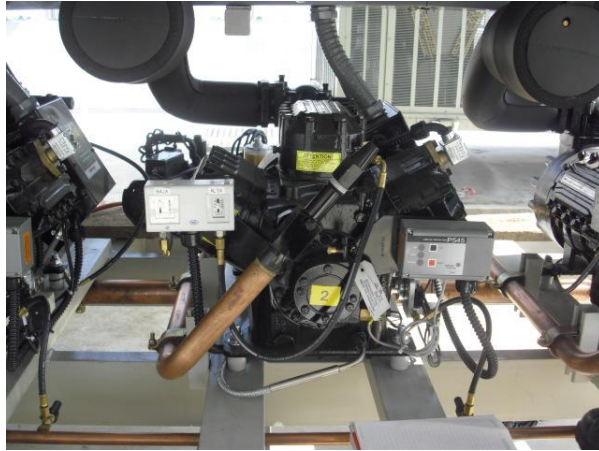
Imagen. 14. Compresor copeland de 34 hp.
