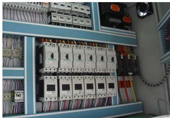
Imagen. 23. Componentes del tablero Eléctrico del Sistema.
