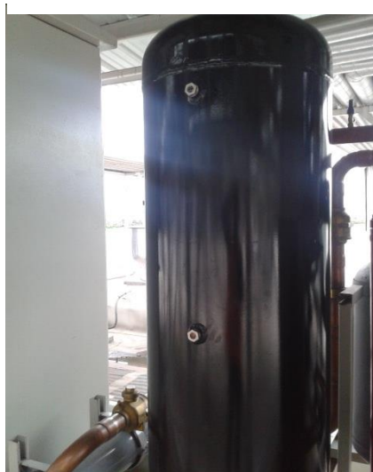
Imagen. 18. . Tanque de Refrigerante R507.
