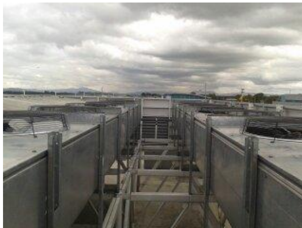
Imagen. 15. Condensadoras Remotas del Sistema de Refrigeración.
