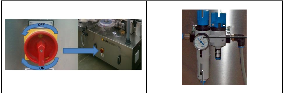
Figura 33 Energización y apertura paso de aire maquina etiquetadora Pago.
