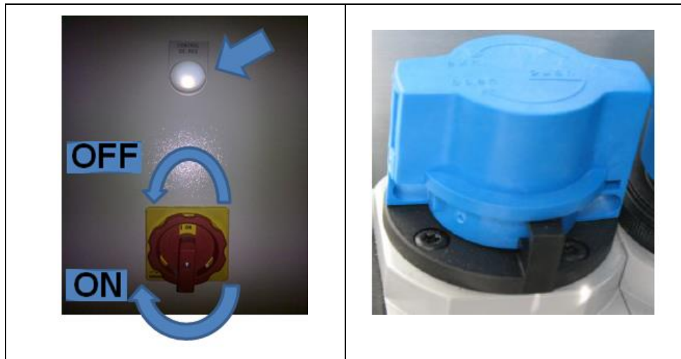
Figura 18. Energización y pasó de aire Envasadora Groninger.
