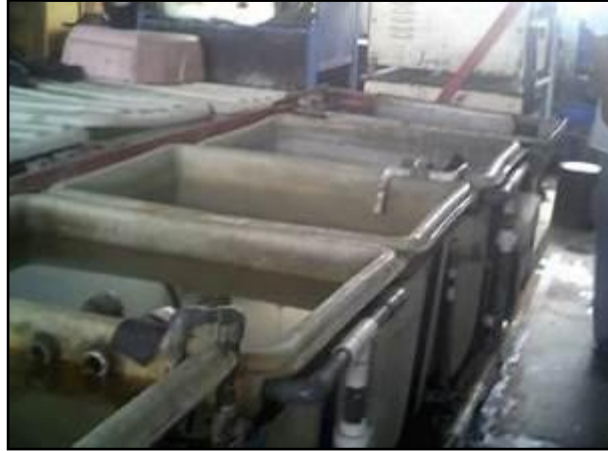
Figura 7. Tanques plásticos utilizados en Fantaxias S.A.S. para el proceso de decapado y neutralizado de piezas MAMU.
