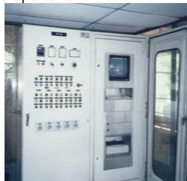
Figura 4.9. Tablero de control del hornos tipo túnel
