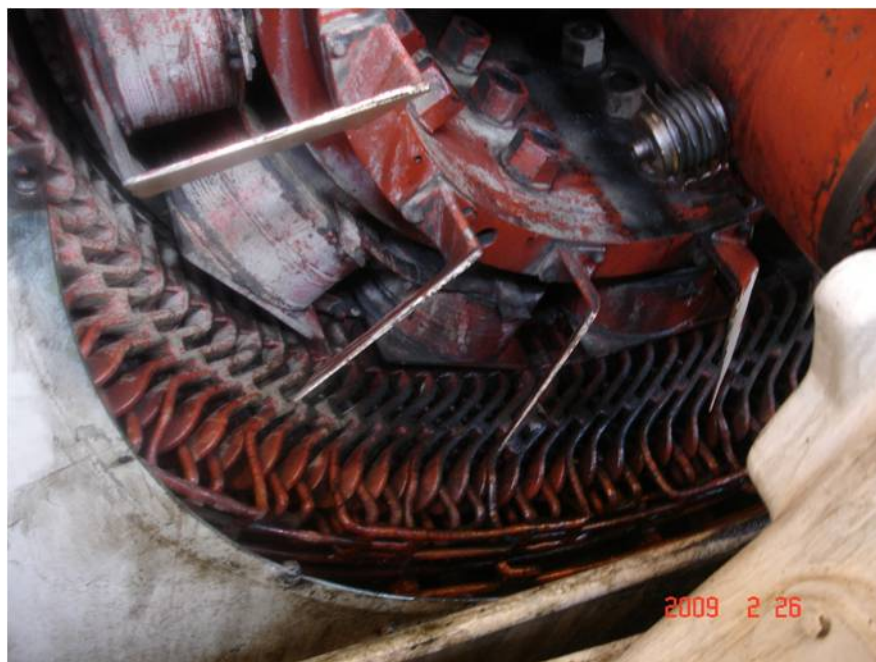
Figura 2.1: Devanado del estator contaminado, debido a daño en una bomba de aceite de lubricación del mecanismo motor
