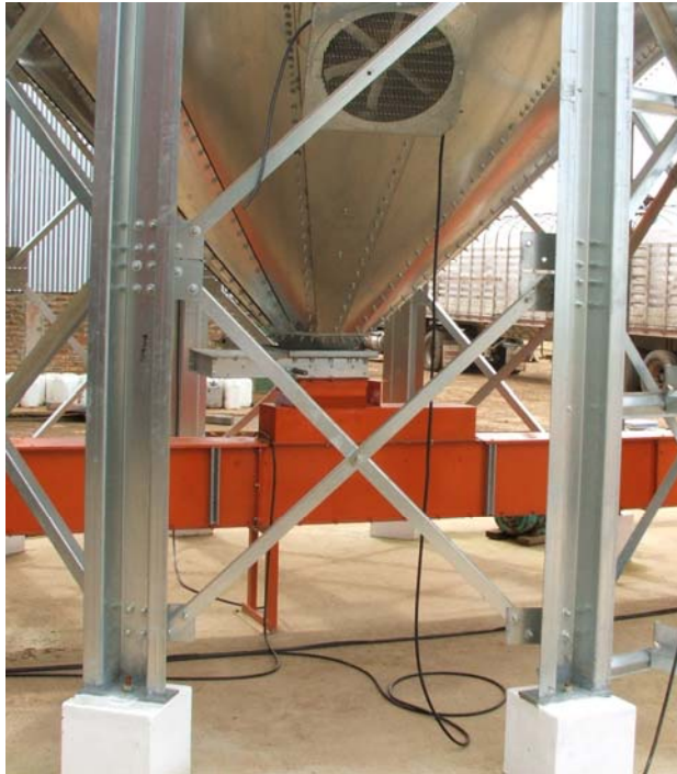
Figura 138. Tolvas de acople de los silos de trabajo al TC-01
