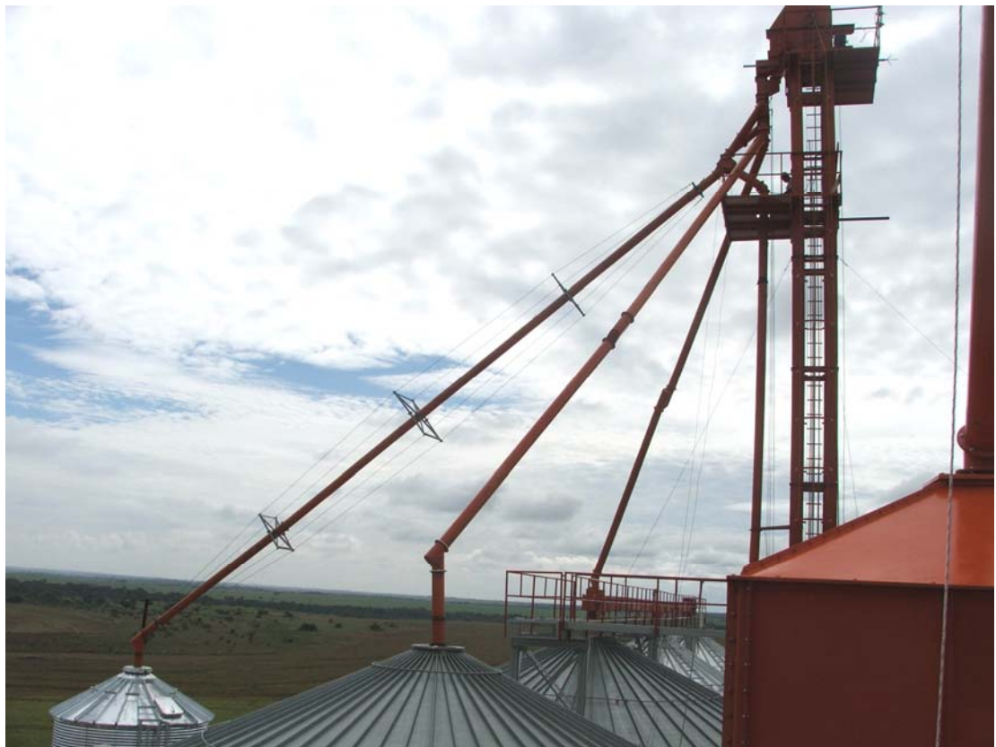
Figura 166. Tuberías de descarga elevadores 4 y 5
