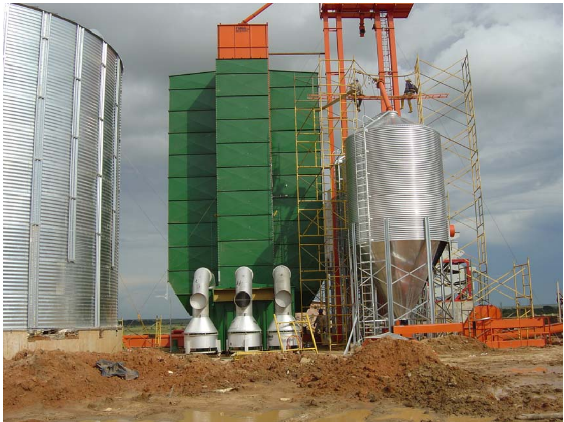
Figura 6. Torre de secamiento y silos de trabajo
