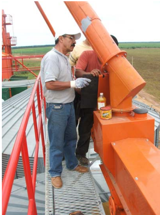
Figura 170. Revisión de los transportadores
