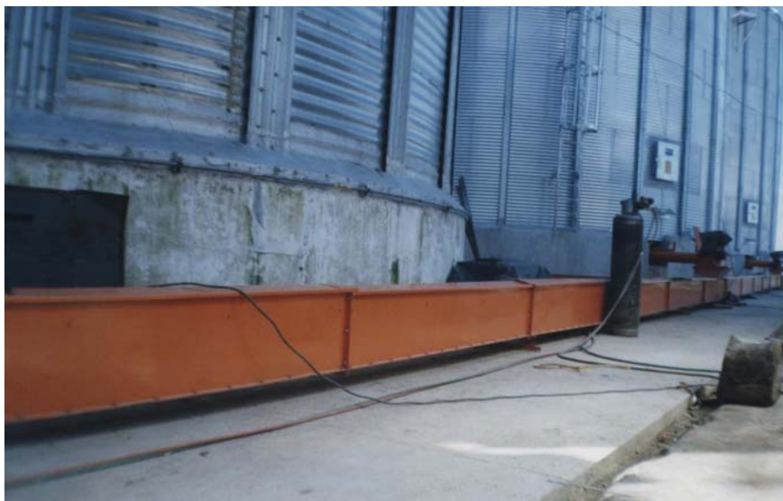
Figura 154. Transportador TC-04 instalado
