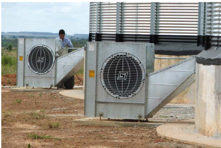
Figura 151. Ventiladores sistema de ventilación
