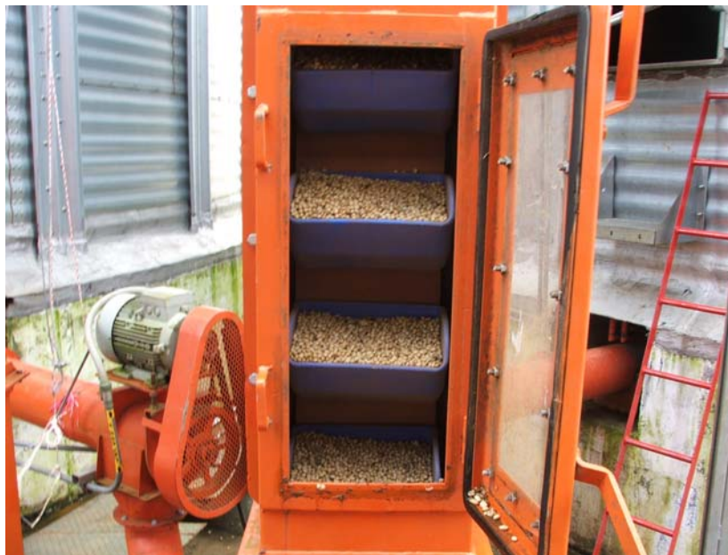
Figura 178. Bloqueo Elevador EL-05
