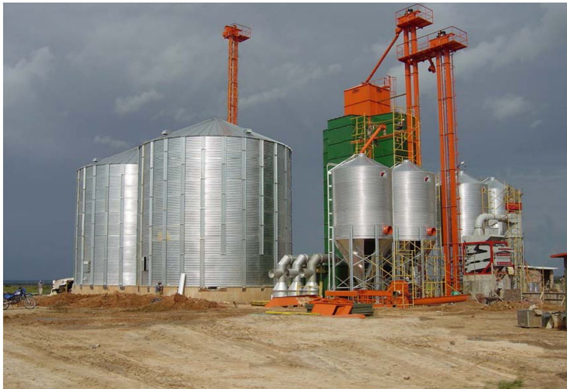
Figura 7. Silos de almacenamiento y trabajo
