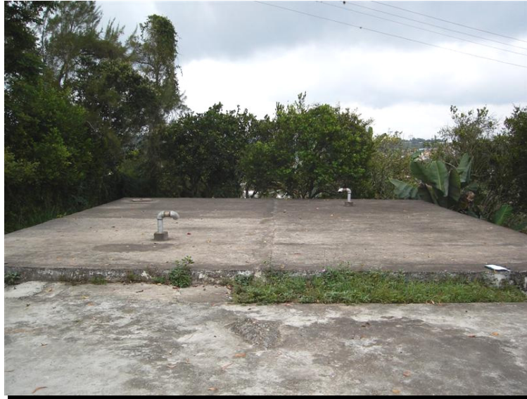
Foto A.8.5. Tanques bajos que reciben el agua de la planta de tratamiento, usados para proveer a los sectores 2 y 3 (ver aplicación SigViewer).
