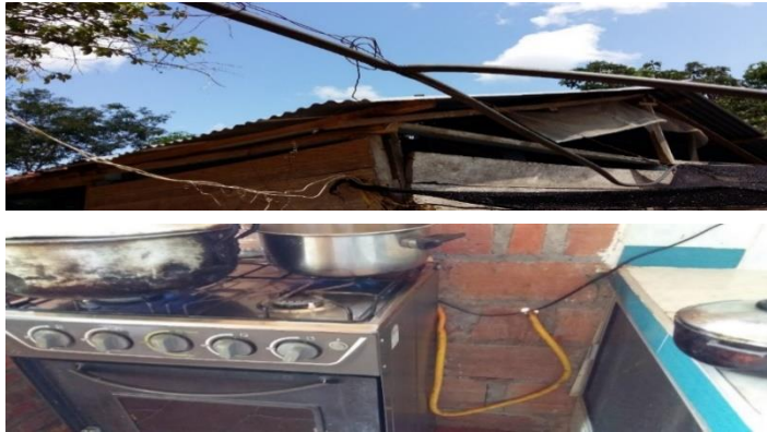
Figura 24. Conexiones ilegales de gas
