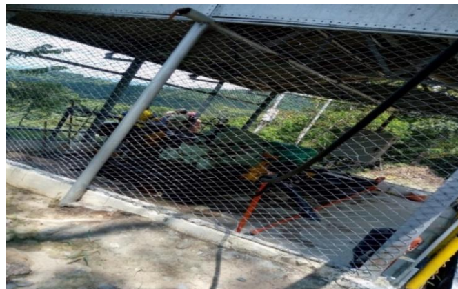
Figura 25. Estación de Bombeo Campo San Luis
