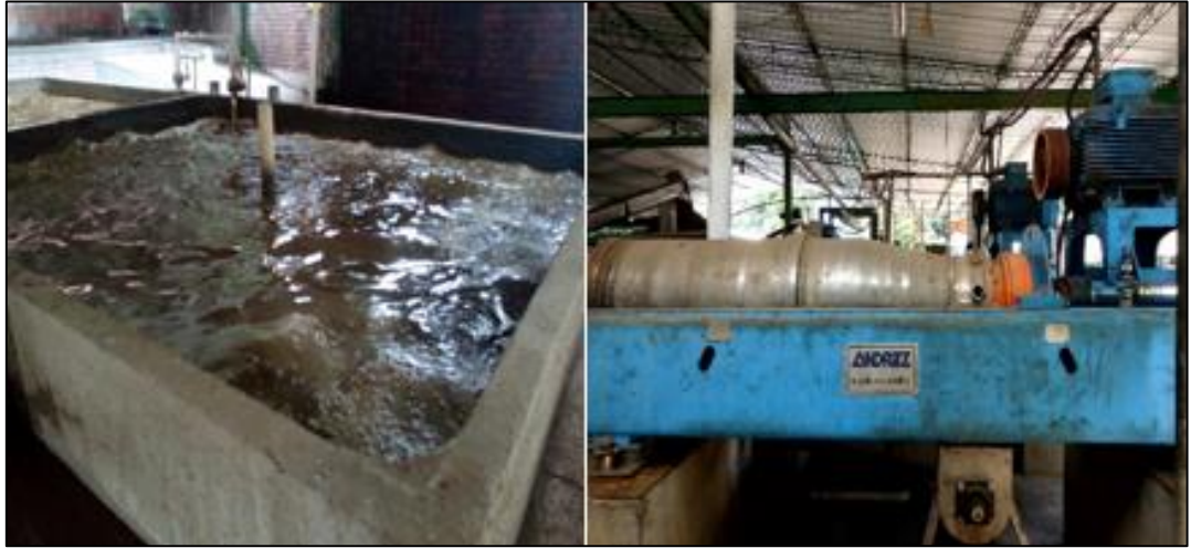
Figura 14. Tanques de agitación y Decantador Centrífugo de la PTAR.
