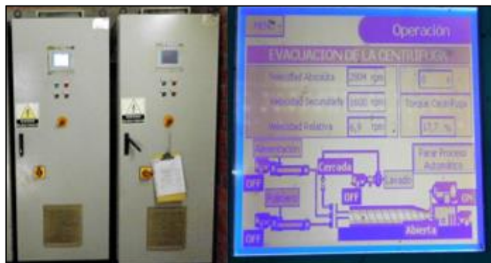
Figura 33. Sistema de control de los decantadores centrífugos.
