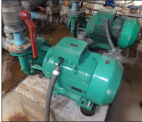
Figura 8. Bombas de distribución de agua potable.
