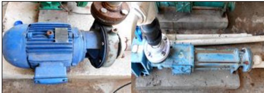
Figura 32. Bombas de auto-lavado (izq.) y bomba de polímero (der.) del decantador centrífugo.
