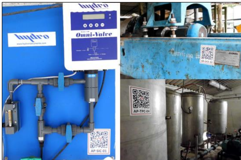
Figura 26. Etiquetas de diferentes equipos.
