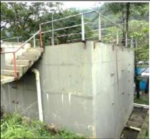
Figura 11. Tanque de igualación de la PTAR.
