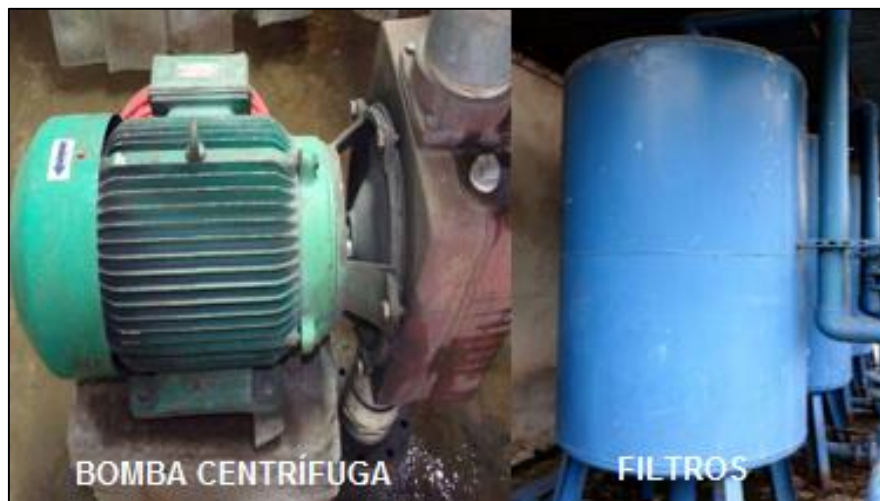
Figura 6. Bomba de filtrado y filtro de arena de la PTAP.
