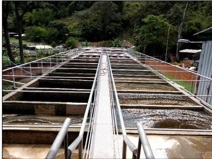
Figura 13. Planta de tratamiento físico-químico de aguas residuales.
