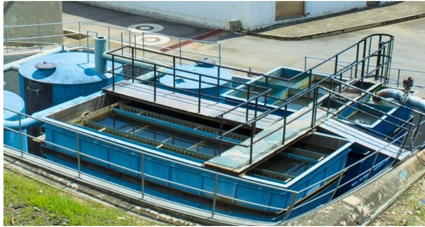
Figura 5. Área de sedimentación de lodos de la PTAP.
