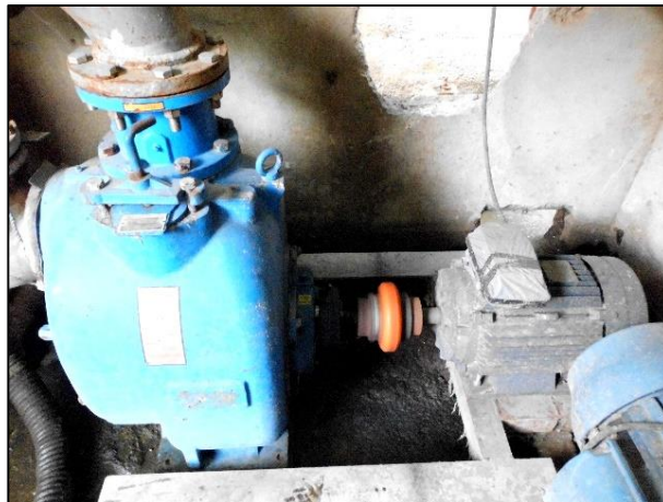
Figura 10. Bombas de impulsión de lodos a los tanques de igualación.
