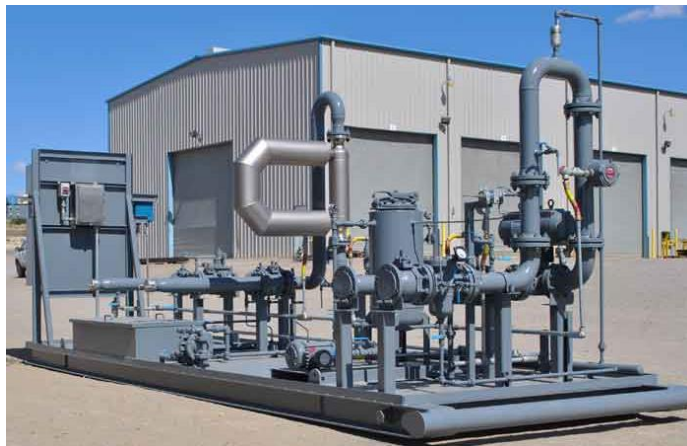
Figura 11. Unidad LACT con medidor másico tipo Coriolis.
