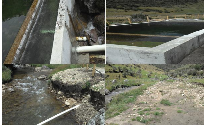
Imagen 46 . Impactos generados por acueducto que va hacia el casco urbano
