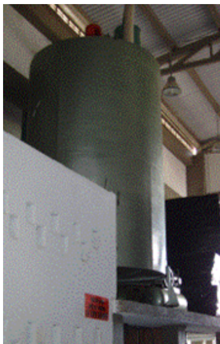
Figura 18. Tanque de almacenamiento triturado espuma área de corte.
