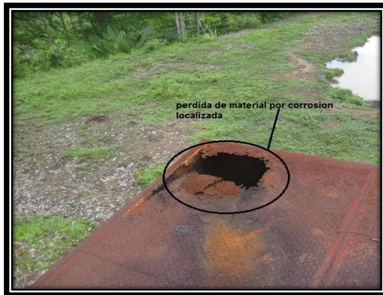
Figura. 8. Pérdida de espesor tanque de almacenamiento colorado 38
