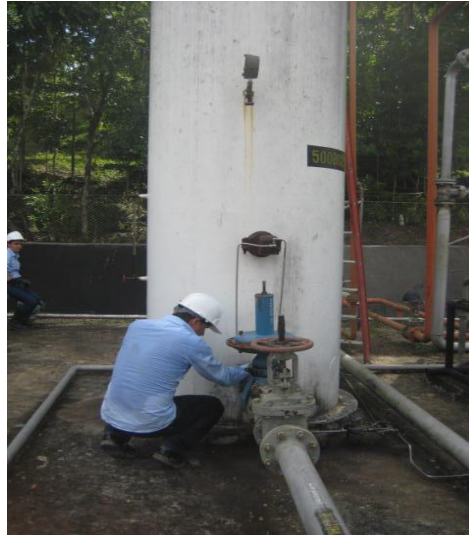
Figura.14 tanque separador general
