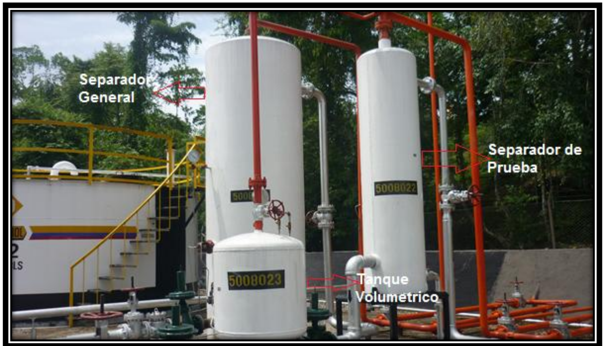
Figura. 42. Toma frontal de la estación recolectora
