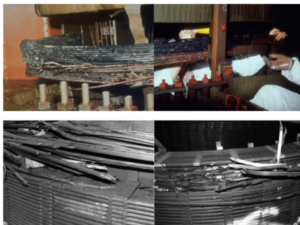
Figura 1. Transformador de la planta nuclear de Salem, EE.UU. dañado por sobrecalentamiento durante la tormenta solar de 1989 ( Imagen superior ). Transformadores de las centrales eléctricas de Lethabo y Matimba en África del sur durante la tormenta solar de 2003 ( Imagen inferior ). Imágenes tomadas y adaptadas de Vijapurapu (2013).
