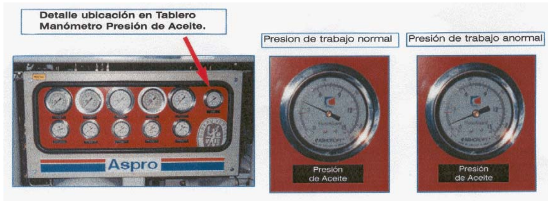
Figura 4.3 Manómetro de presión de aceite del compresor ASPRO de la Estación el Carmen (Girón – Santander)
