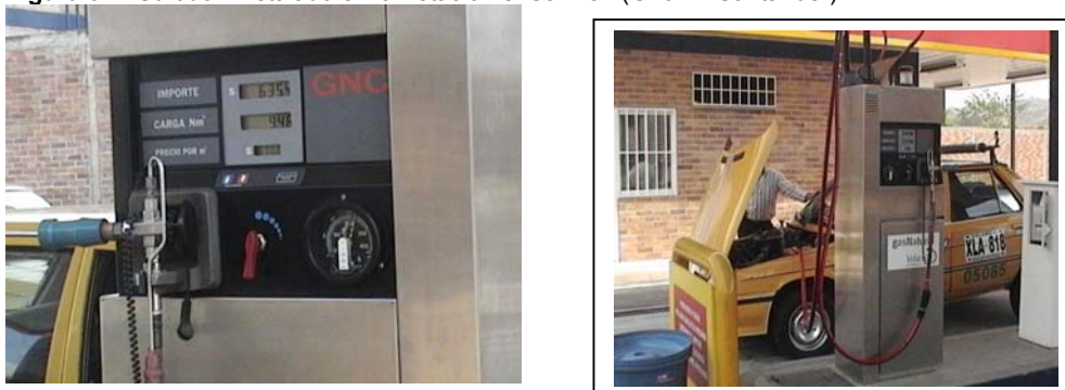
Figura 5.7: Surtidor instalado en la Estación el Carmen (Girón – Santander)
