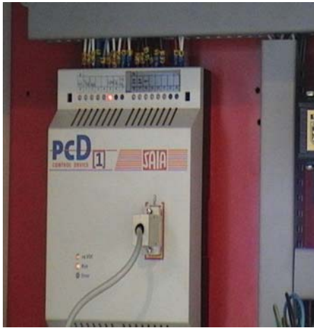
Figura 5.5 PLC instalado en la estación de servicio.
