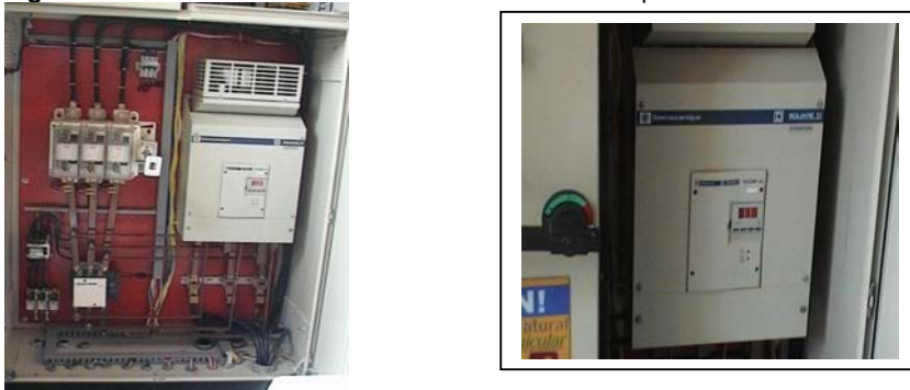
Figura 5.10 Arrancador suave del motor eléctrico del compresor
