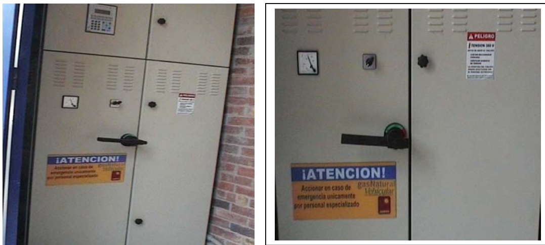
Figura 5.3 Tablero de control de la Estación el Carmen (Girón-Santander)
