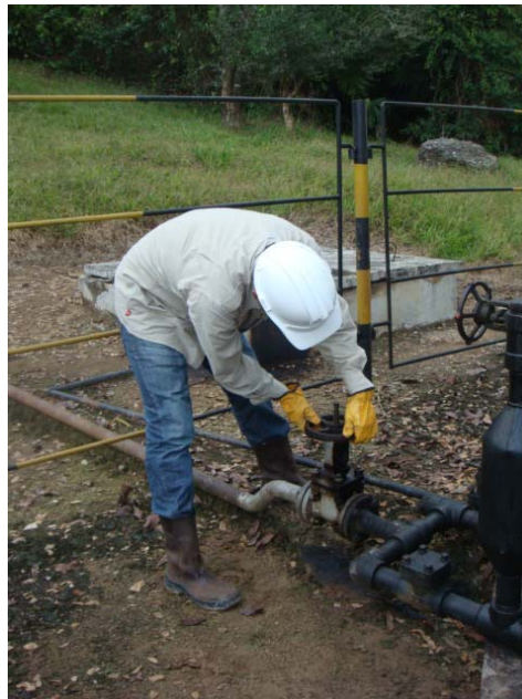
Figura 40. Cierre de Válvulas 2
