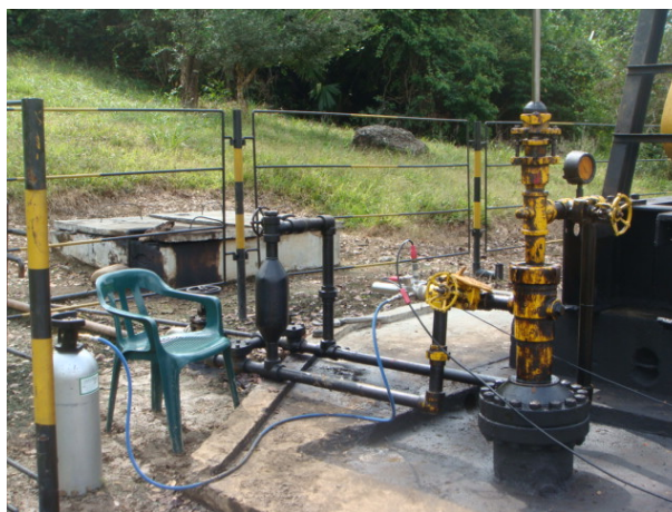
Figura 44. Montaje Final del Equipo
