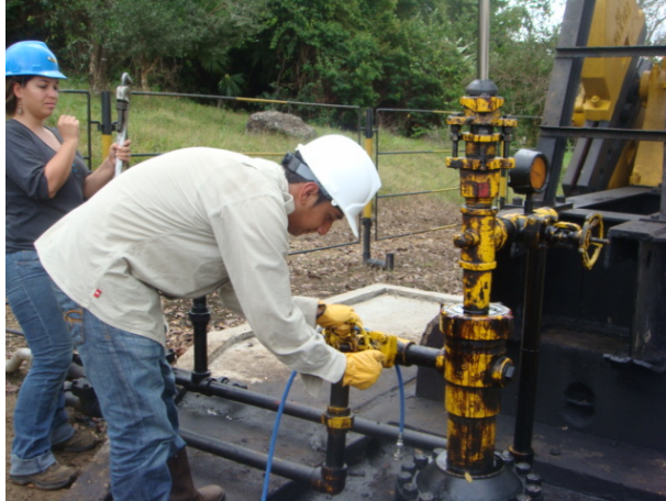
Figura 39. Cierre de Válvulas
