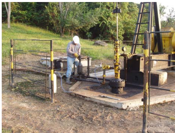
Figura 47. Verificación de las Válvulas
