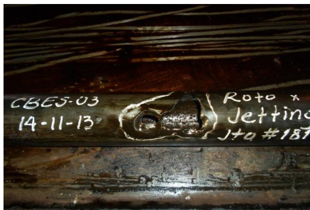
Figura 16. Tubería por efecto Jetting
