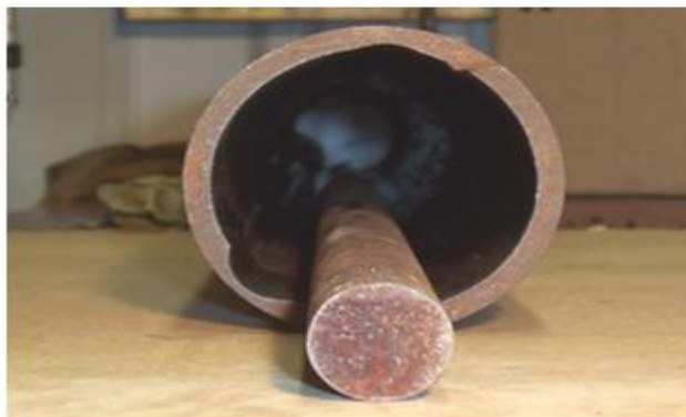
Figura 13. Desgaste de pared de tubería por rozamiento con varilla continua
