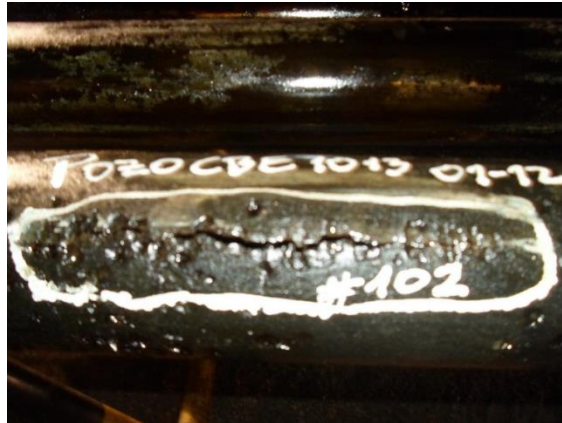
Figura 17. Tubería desgastada por corrosión
