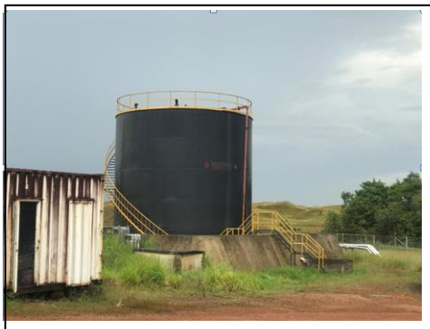
Figura 35. Tanque de despacho
