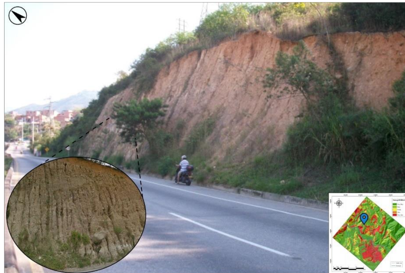
Figura 33. Afloramiento de depósito no consolidado sobre la vía Bucaramanga – Rionegro, 500 metros delante de la entrada a Cemex. En el detalle es posible observar evidencias de la acción erosiva del agua y la gravedad con cárcavas con apretura y profundidad entre 0.5 y 1 m. Esta zona de encuentra clasificada con una susceptibilidad Alta dentro del respectivo mapa.
