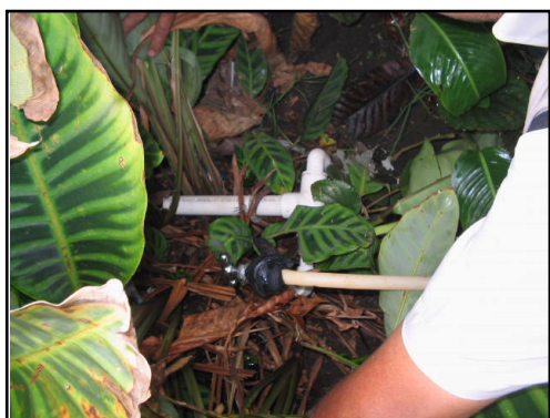
Figura 18. Conexión clandestina antes del empalme al medidor
