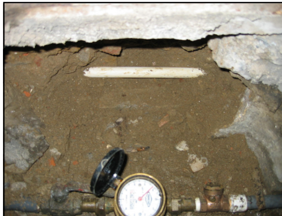
Figura 21. Conexión Clandestina paralela no registrada
