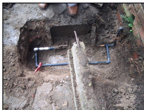
Figura 19. Conexión clandestina paralela antes del medidor
