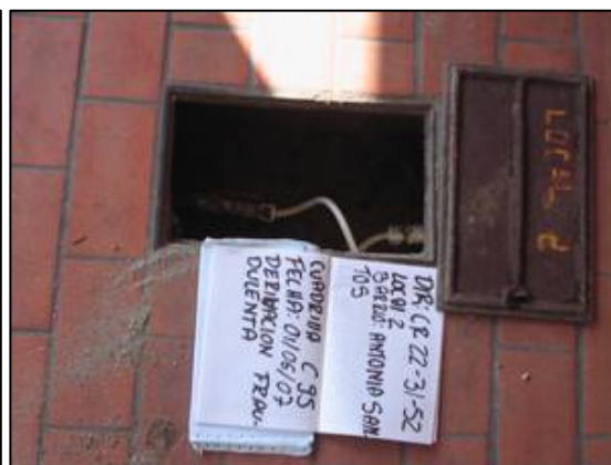
Figura 8. Paso directo utilizando manguera de sanitario
