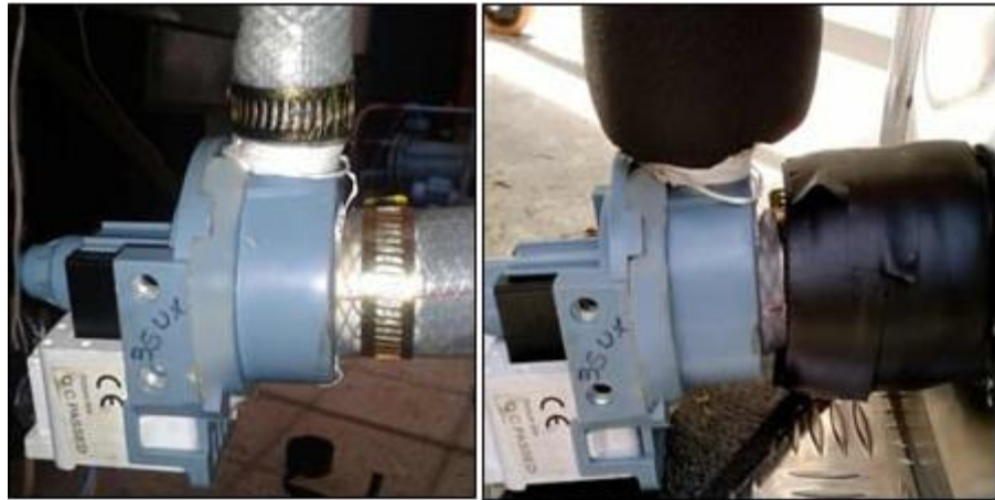
Figura 117. Bomba de circulación de agua instalada
