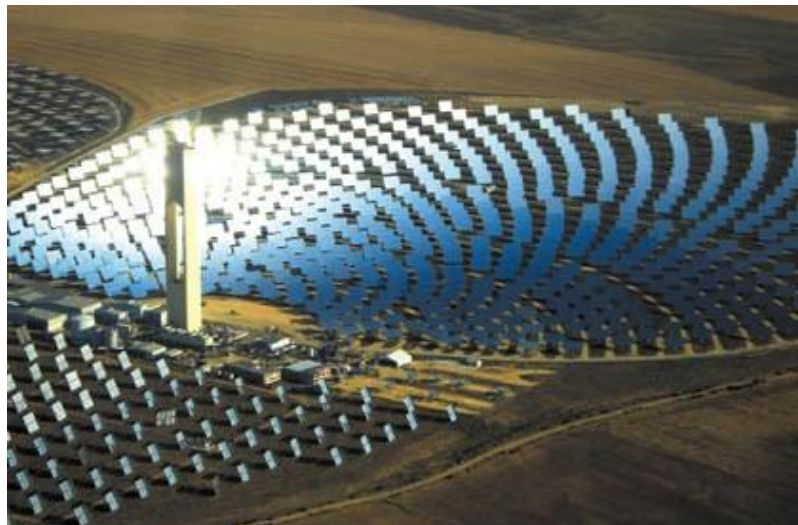
Figura 11. Central solar térmica
