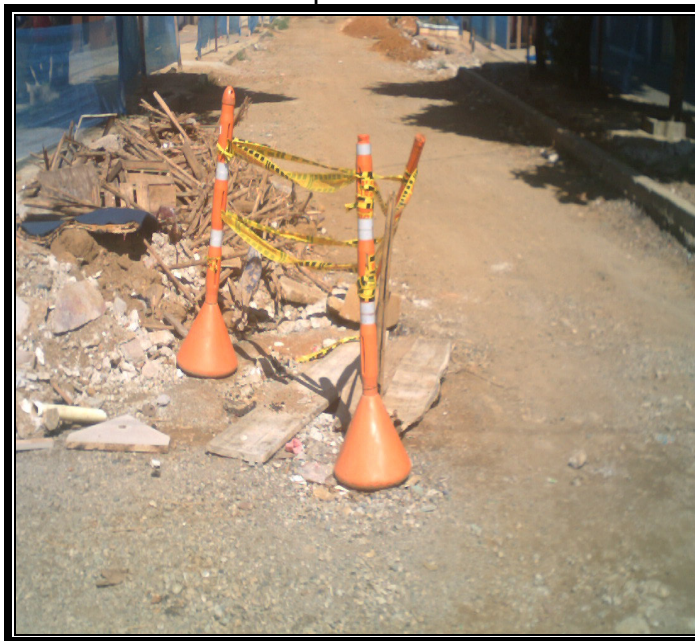
Figura 24. Escombros causados por comunidad dentro del área de obra
