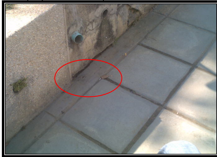
Figura 26. Problema con diseño de control de aguas posterior a la terminación de las obras del proyecto, acá se provoca un daño de los materiales
