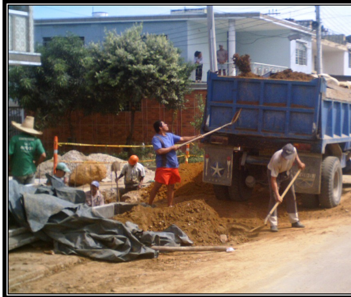
Figura 20. Trabajadores sin elementos de protección personal.
