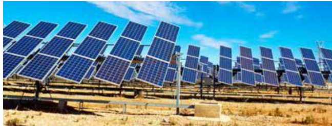
Figura 5 Un sistema FV, con conexión a red en suelo.
