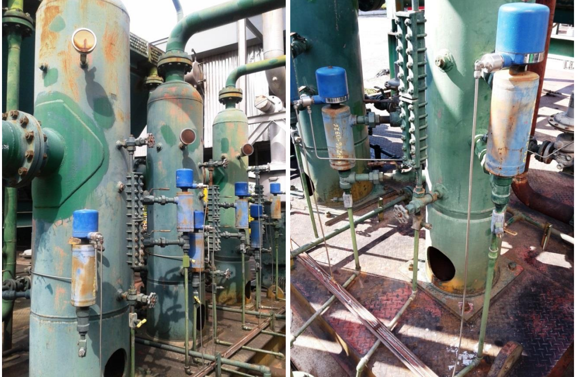
Figura 34. Switches nivel scrubber etapas compresión
