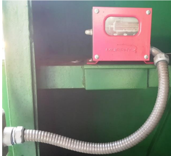
Figura 21. Switch de vibración enfriador
