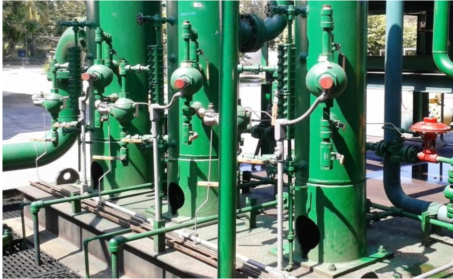
Figura 20. Switch de Nivel Scrubber
