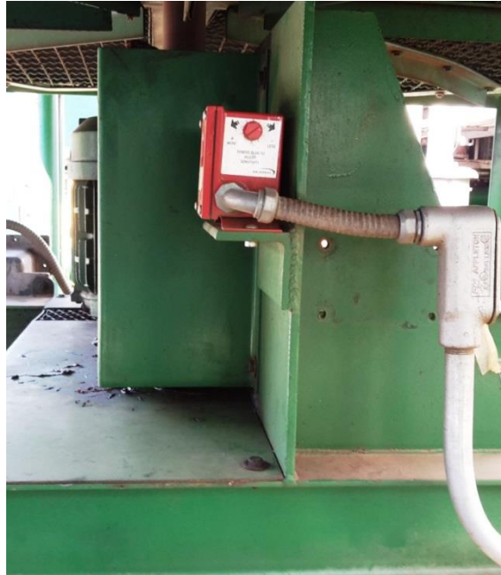
Figura 23. Switch vibración ventilador auxiliar
