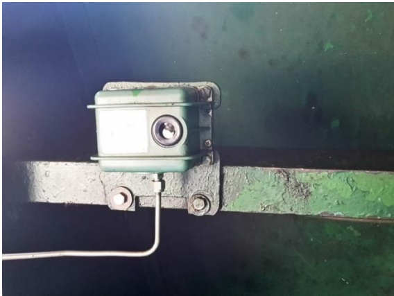
Figura 35. Switch de vibración enfriador
