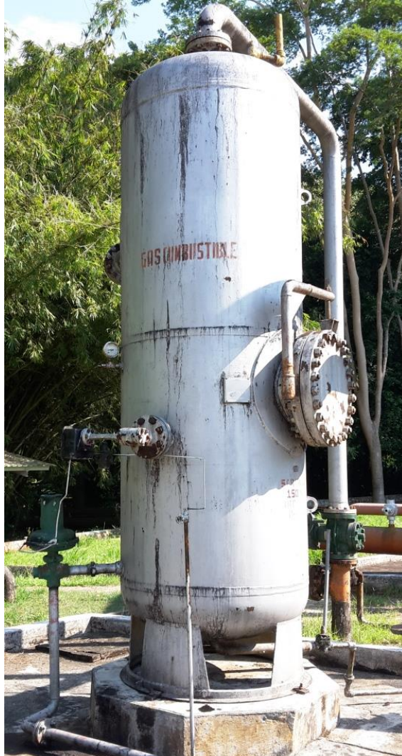
Figura 9. Scrubber de gas combustible estación santos
