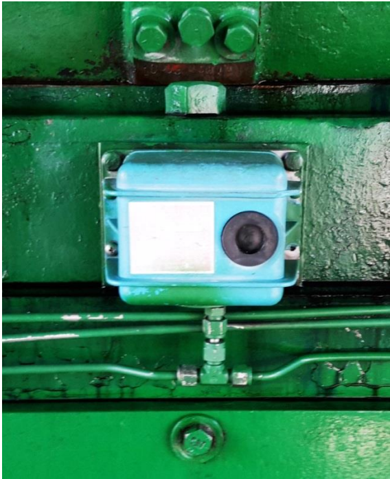
Figura 36. Switch de vibración motocompresor
