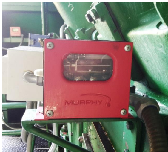
Figura 22. Switch de vibración motocompresor
