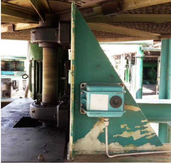
Figura 37. Switch de vibración ventilador auxiliar
