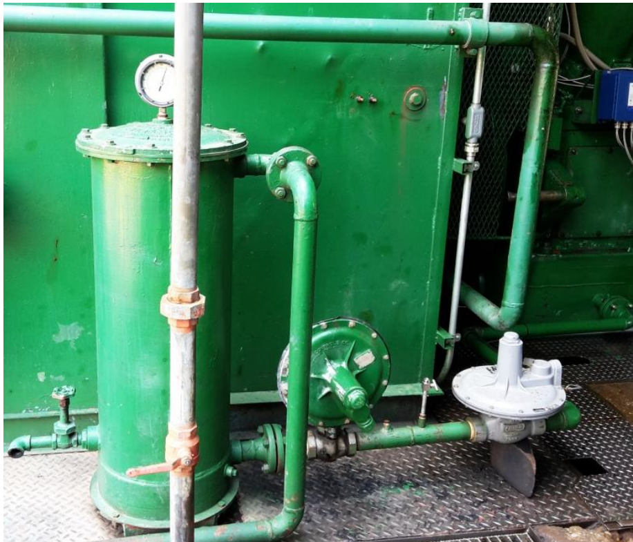
Figura 10. Regulador de primer (marca Sensus modelo 121-12) y segundo corte (marca Fisher modelo S-201M), conexión 2" NPT Hembra
