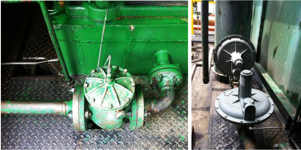
Figura 26. Válvula de corte neumática, regulador primer corte, regulador segundo corte.
