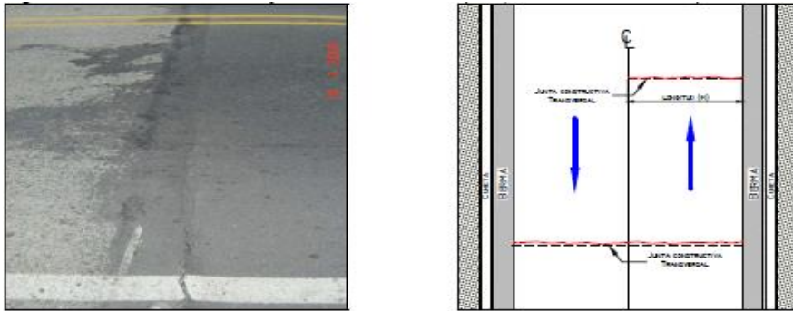
Figura 23. Fisura transversal en junta de construcción (FCL).
