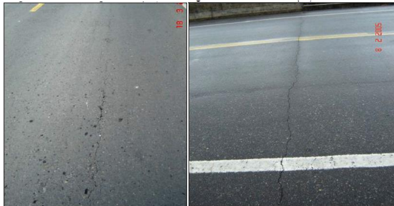
Figura 21. Fisura longitudinal (FL), Fisura transversal (FT).
