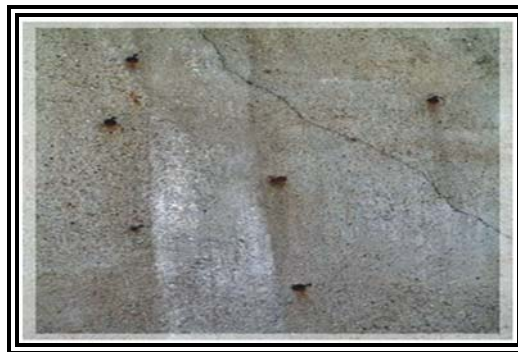
Figura 71: Fisuras en el hormigón
