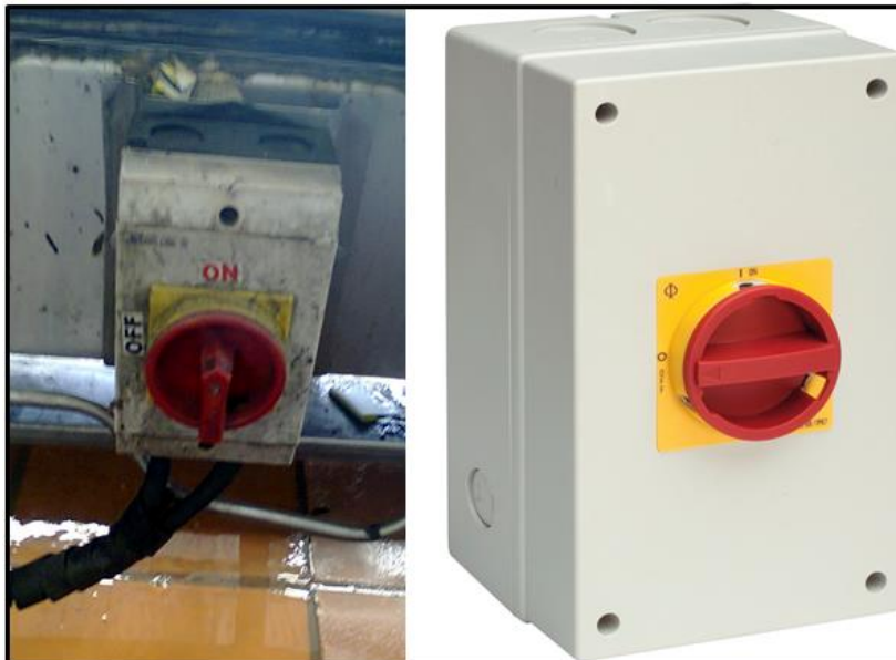
Figura 133. Switch encendido y apagado de cada motor
