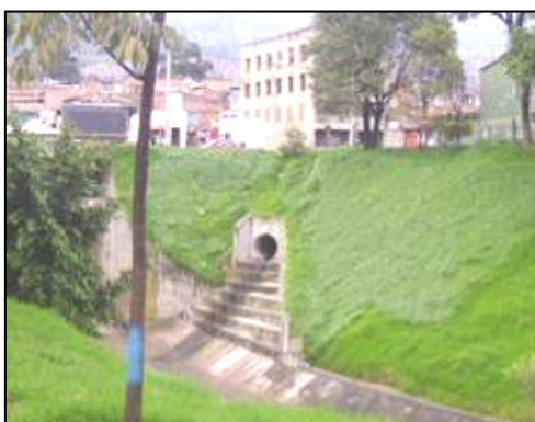
Foto 5. Margen izquierdo. Descole tubería de 1,20 m, se evidencia la salida de caudal
