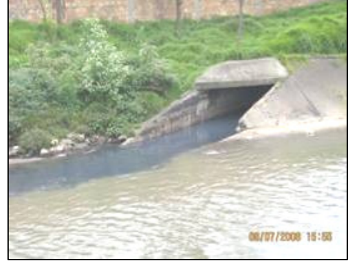
Foto 13. Punto de descarga al margen derecho del Río Fucha aguas abajo de la Carrera 69, proviene de red pluvial
