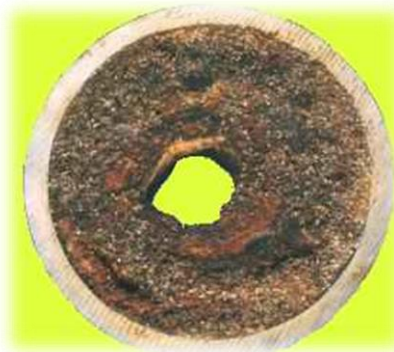
Figura 3. Tubería con precipitación de parafinas.
