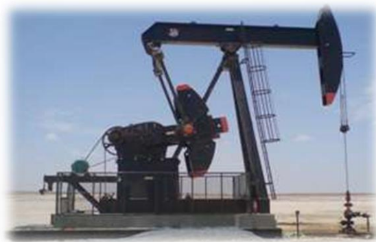
Figura 1. Equipos de superficie del sistema de levantamiento artificial bombeo mecánico convencional
