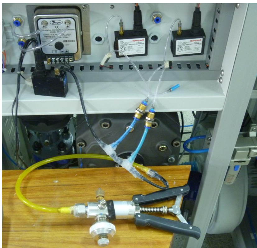
Figura 39. Montaje usado para calibración de barómetros. Fuente: CDT de GAS.
