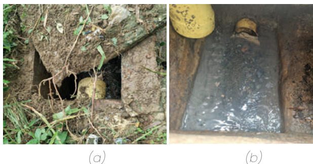
Fotografía 8. Cámaras de inspección de nuestra comunidad: CS15 (a) y CS16 (b)
