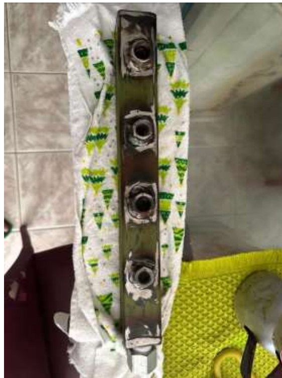
Figura 23. Distribuidor hidráulico con los racores ya acoplados
