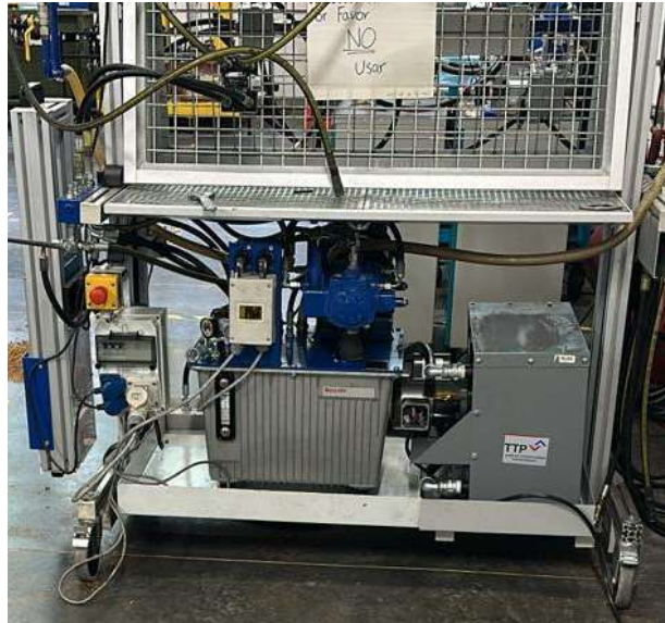
Figura 22. Banco con el intercambiador de calor incorporado
