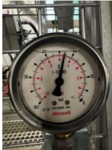
Figura 18. Manómetro usado para la prueba de presión
