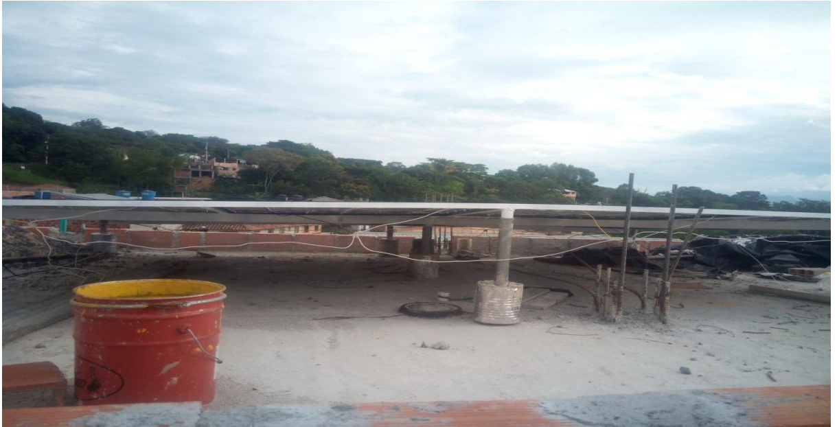
Figura 78. Conexiones eléctricas parte baja de los módulos solares
