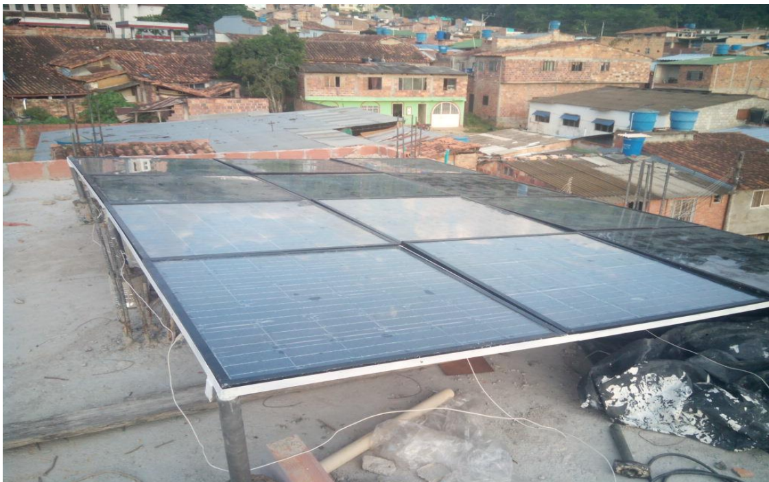
Figura 77. Módulos solares en operación sobre la terraza
