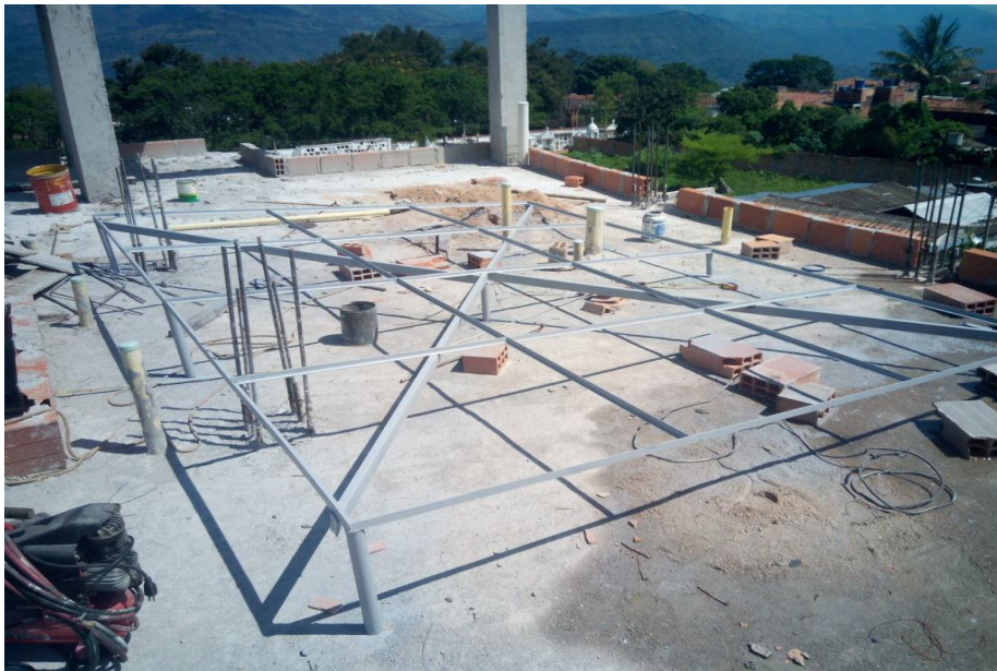
Figura 64. Estructura base de soporte de los módulos solares
