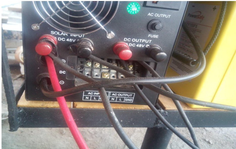
Figura 76. Conexión inversor parte trasera 2
