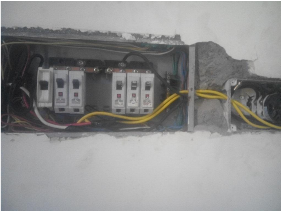
Figura 72. Conexión entre las cajas para la entrada de los cables de la energía PV
