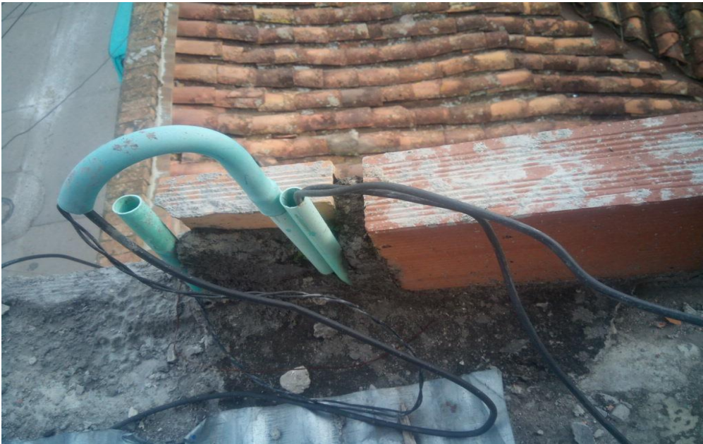
Figura 73. Tubos de PVC para la entrada de los cables con energía alterna
