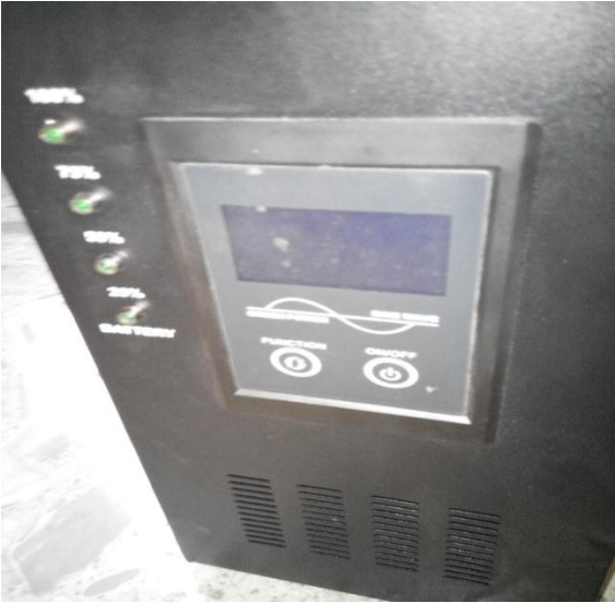
Figura 66. Parte frontal del inversor
