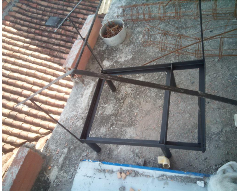
Figura 69. Estructura de soporte de las baterías e inversor
