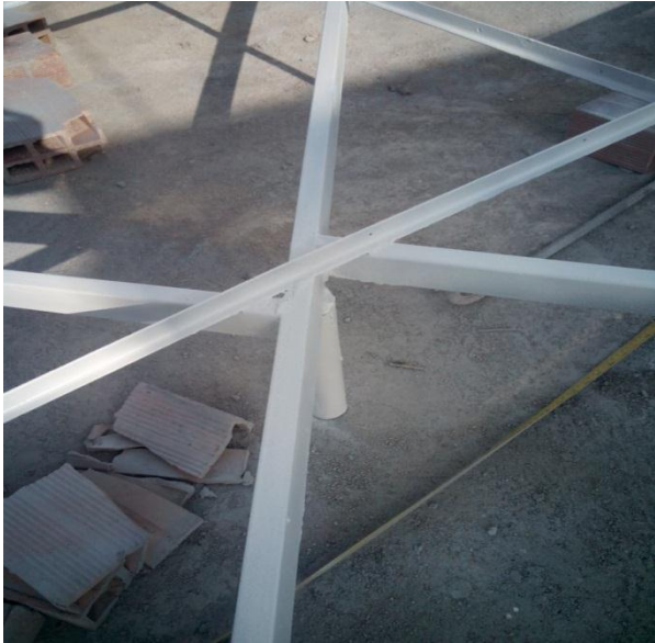
Figura 65. Centro de estructura de los módulos solares
