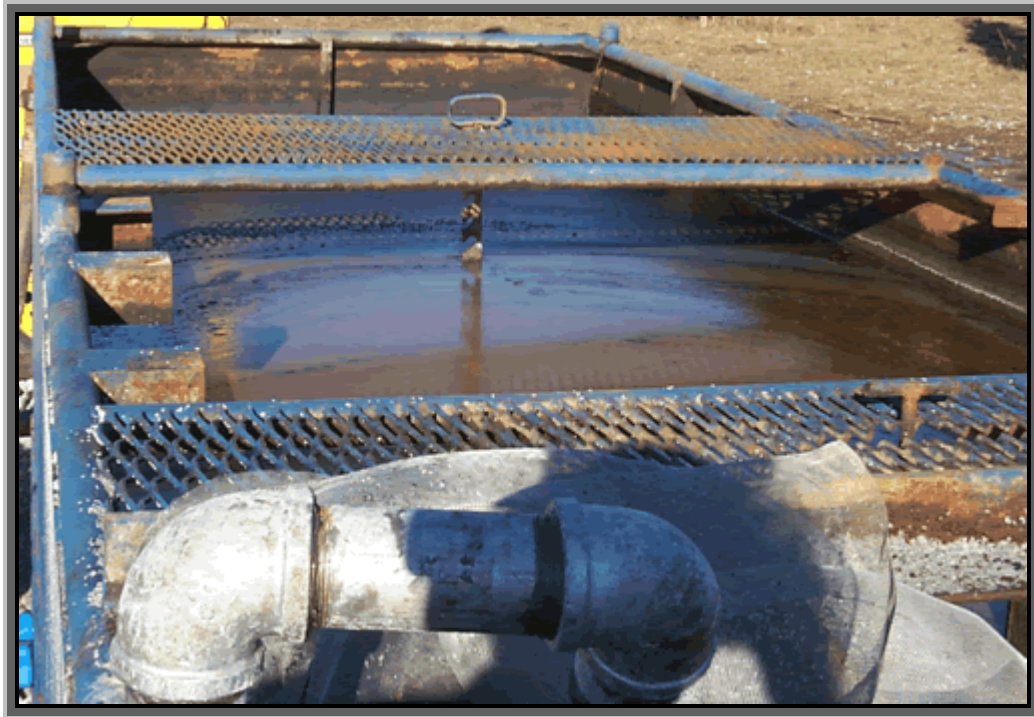
FIGURA 7. Tanque de almacenamiento
